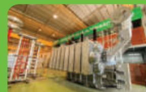
LABORATÓRIO DE ALTA TENSÃO
